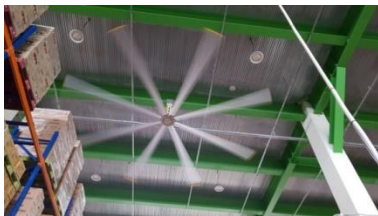
에코팬 설치를 통한 전력사용량 절감 (스탠딩팬 50대 대체 효과)
